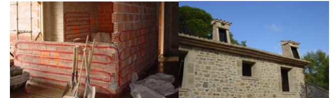
Muro bajo radiante
